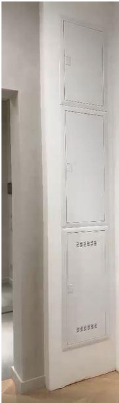
Пример реализации эл-го щитка
